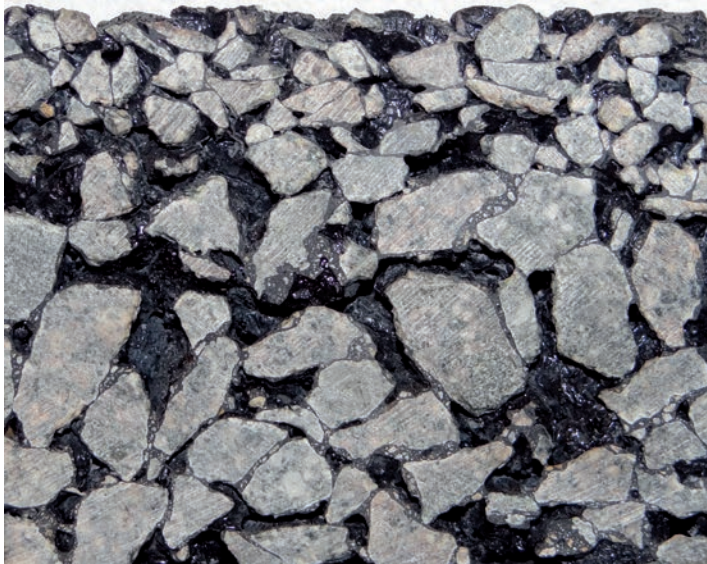
De scheiding tussen toplaag en onderlaag is niet strak.
